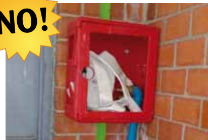
ESEMPIO DI NASPO in cassetta esterna con assenza di diversi componenti
